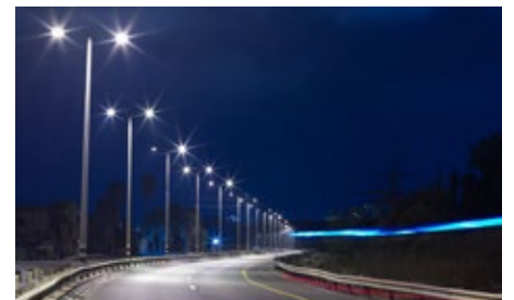
Aydınlatma ve kontrol sistemi
